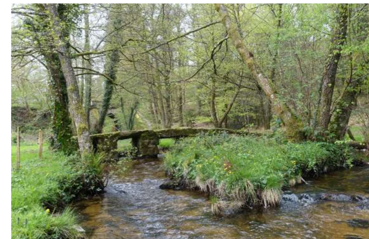
Fermeture spectaculaire du paysage sur le site du pont dit romain de Saint-Léger-la-Montagne
