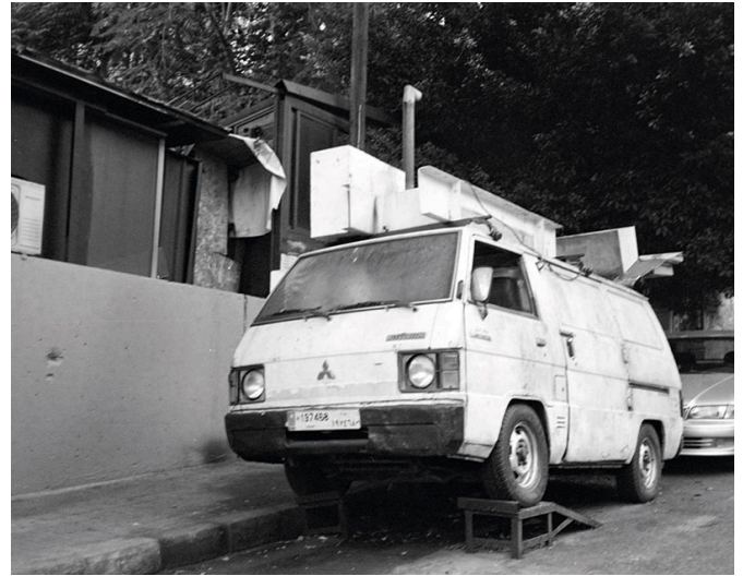
Dans cette fourgonnette Mitsubishi, un générateur tourne h24 pour pallier les coupures incessantes d'électricité fournies par les générateurs privés aux heures de pointe. L'électricité publique, elle, est désormais fournie environ une heure par jour au petit matin. ©Matéo Bouchaud
